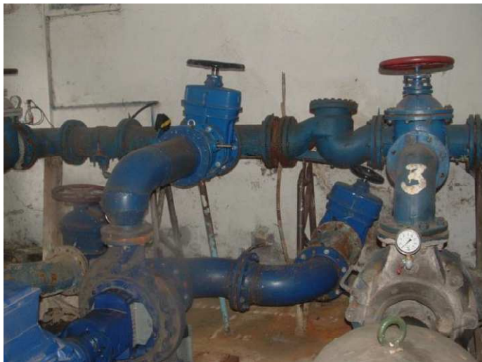
Pumpno postrojenje na PS „Breznica“ prije radova na sanaciji
